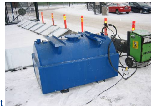
Työmaasähkö ja lämmitys
